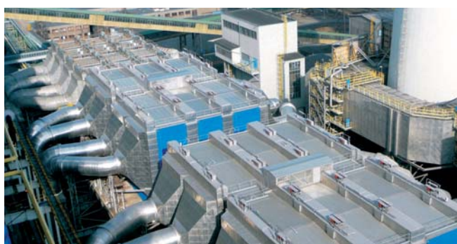
Elektrické odlučovače po rekonstrukci.
