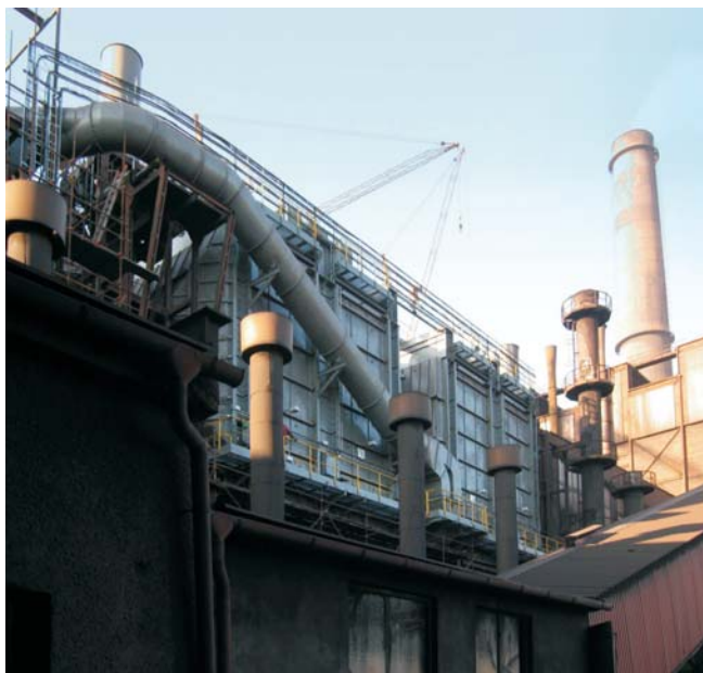
Odlučovače plynů v ArcelorMittal Ostrava
